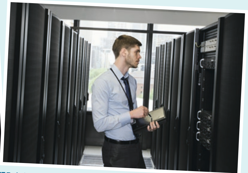
IT-Techniker kontrolliert im Serverraum
